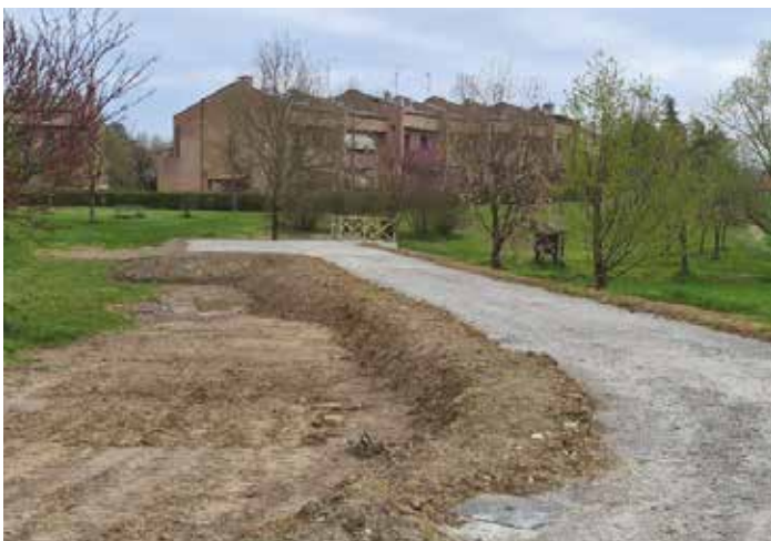
Rio Marzano. Argine carrabile e piazzale di predisposizione per lo sgrigliatore
