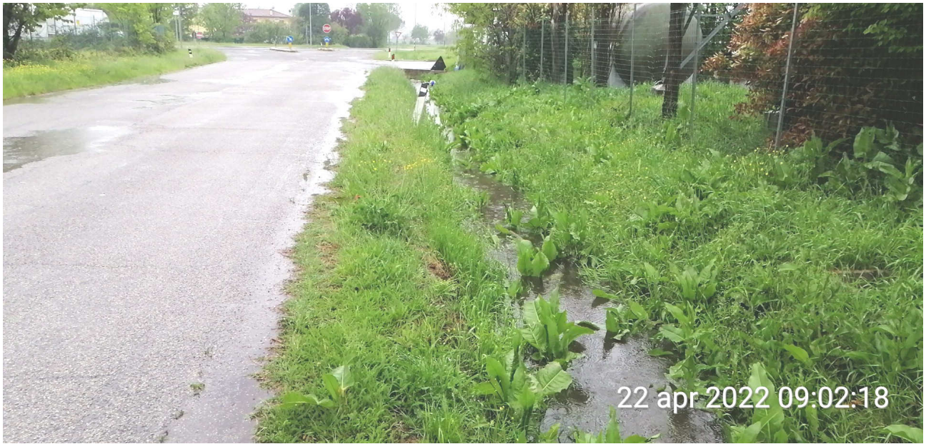
Foto 4 - Fosso ovest Via Ca' Fornacetta in direzione sud, scolo acque Hera spa
