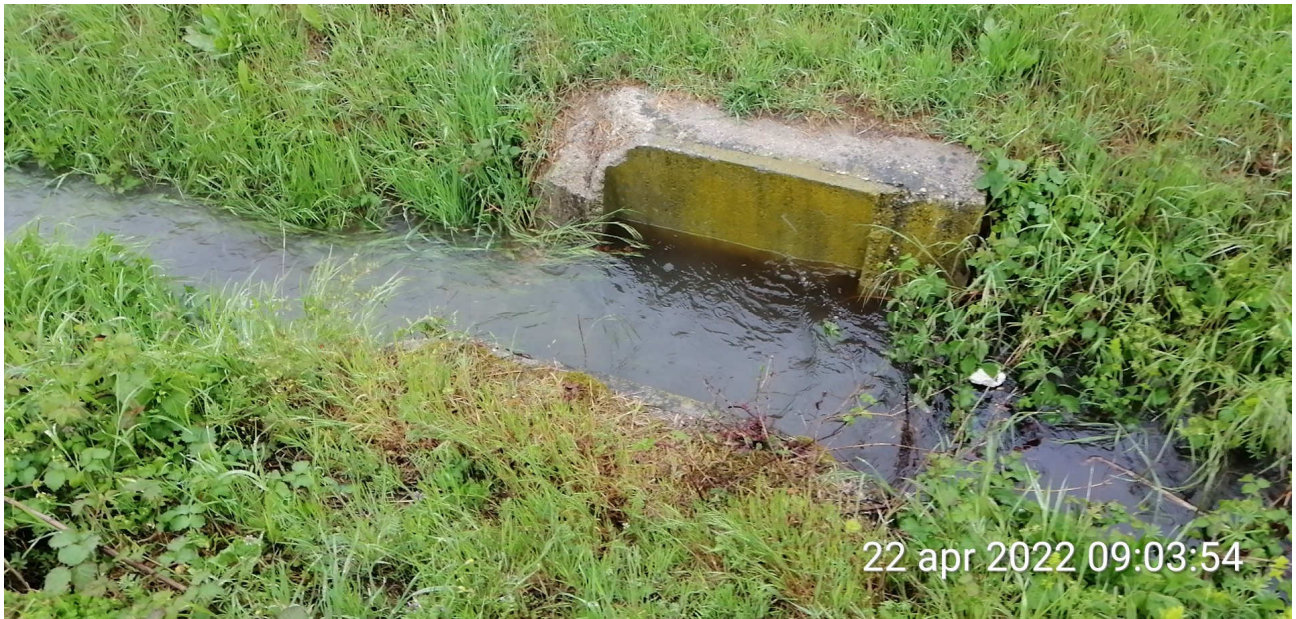
Foto 8 – Tombamento per attraversamento Via Stradelli Guelfi
